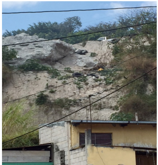
Fotografías 9 y 10: Colapso de talud Km 10.8, zona 18, Carretera al Atlántico, Guatemala, y sector La Pinada, Santa Lucía Milpas Altas, Sacatepéque. Fuente: SE-CONRED.
