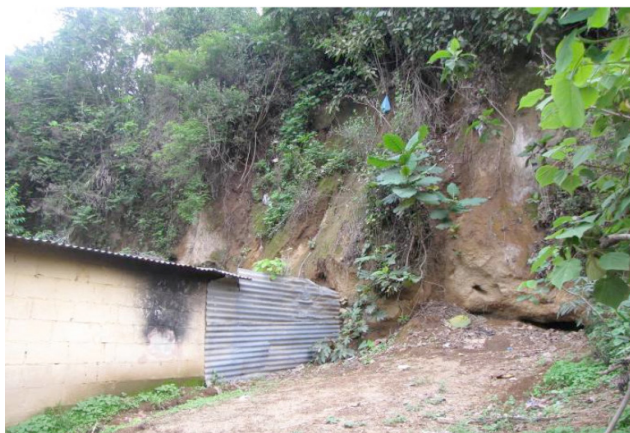
Colapso de talud Km 10.8, zona 18 Fuente: SE-CONRED.
